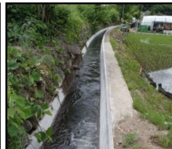
老朽化した用水路の整備・更新
